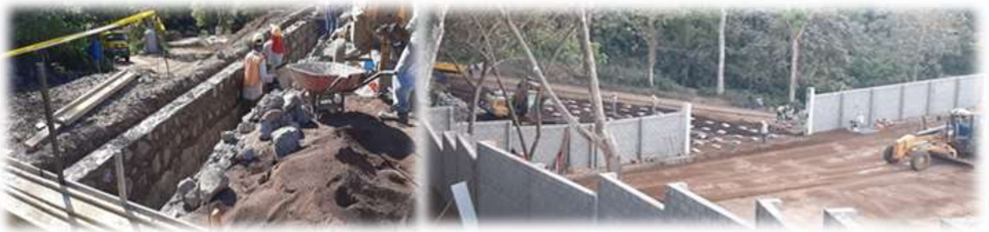
Construcción de canaleta perimetral y Proceso de compactación de capa de suelo cemento.
