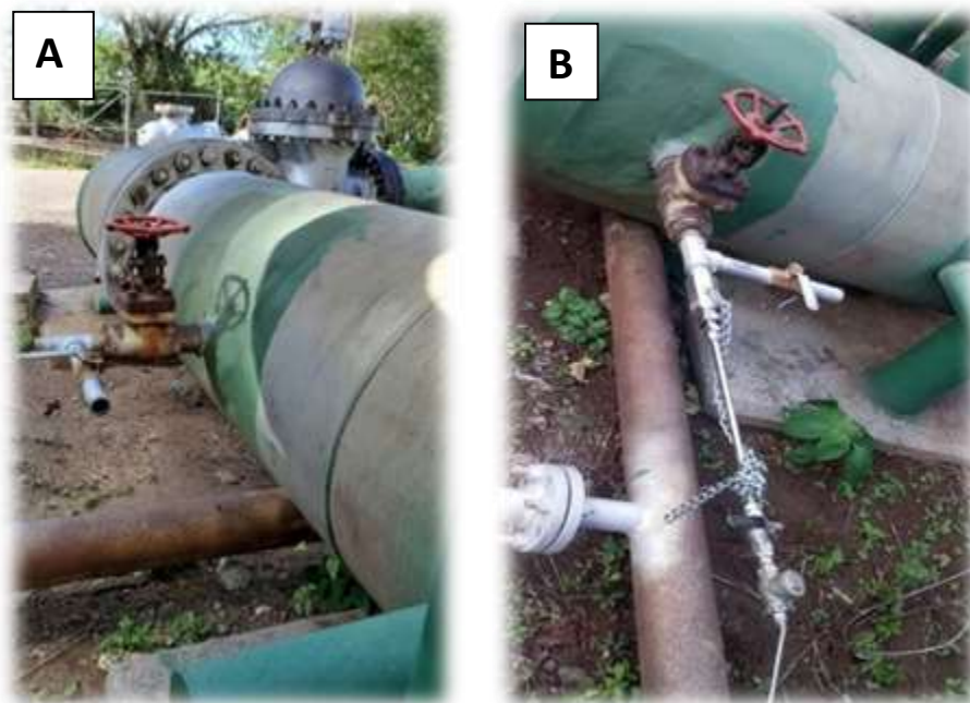
Figura 10: A) Puntos de dosificación sobre línea bifásica. B) Quill retráctil instalado sobre Puntos de dosificación en vertederos del separador atmosférico.
